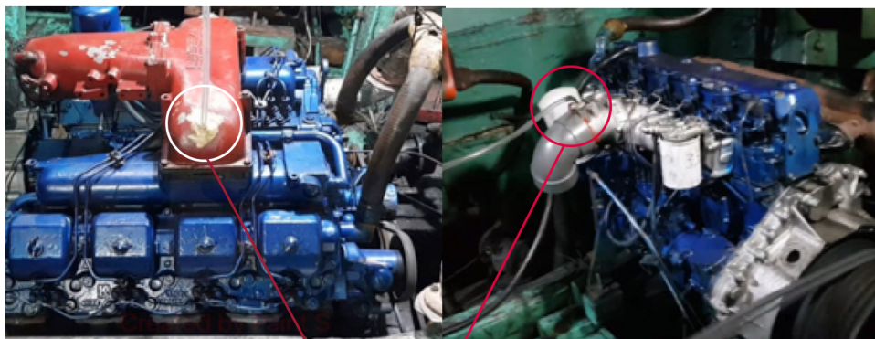
Gas hidrogen masuk ke manifold melalui selang/pipa
